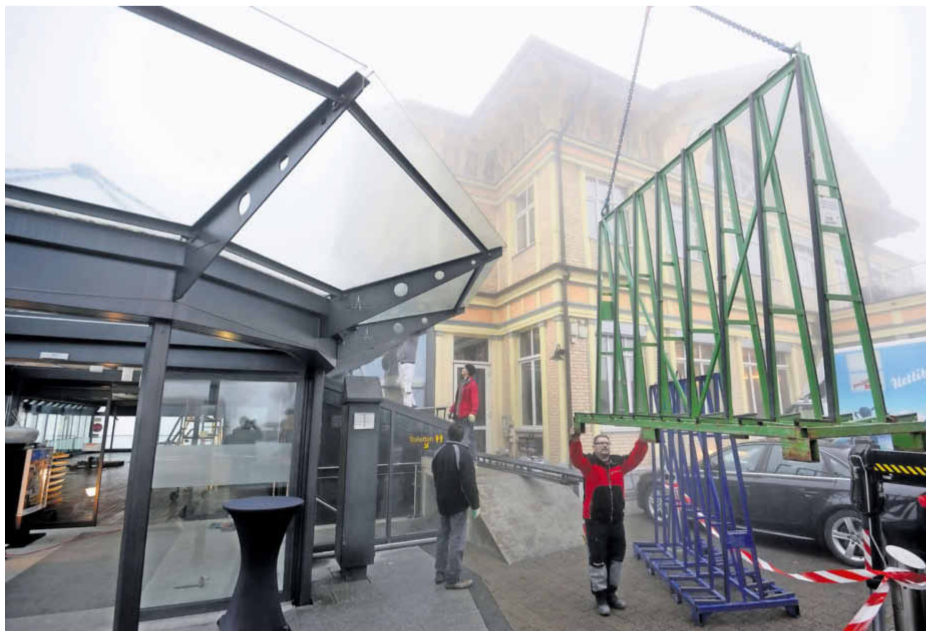
Die illegalen Aufbauten aus Glas am Restaurant Uto-Kulm auf dem Uetliberg werden seit gestern fachmännisch entfernt.
